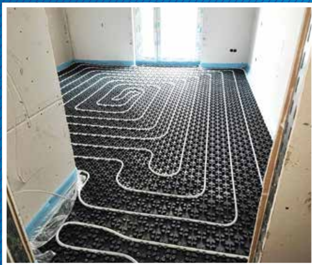
Blick in das Staffelgeschoß Eichbuschallee 9F, Fußbodenheizung in der Musterwohnung
