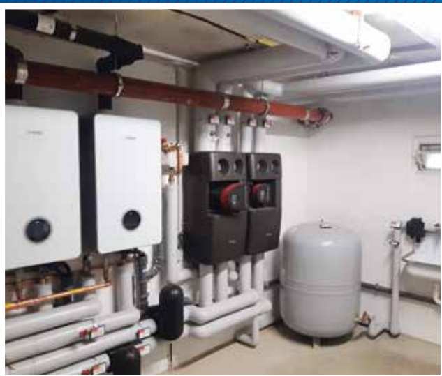
Moderne Heizungsanlage in der Eichbuschallee 41c
