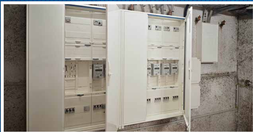
Zählerzentralisation in der Sonnenallee 404–410
