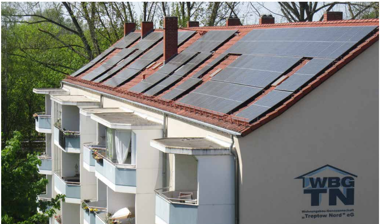
Photovoltaikanlage auf dem Dach des Objektes Leiblstraße 11–13
