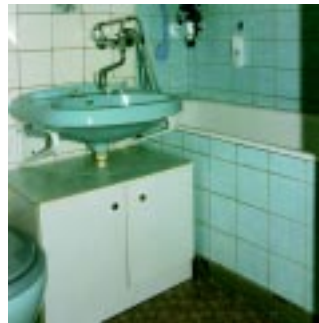
Schlechte Bad-Ausstattung mit dem spröden „Charme des Ostens“ vor der Sanierung.
