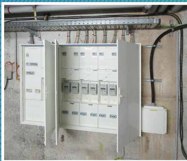
Zentraler Zählerplatz in der Erich-Lodemann-Straße 105–113
